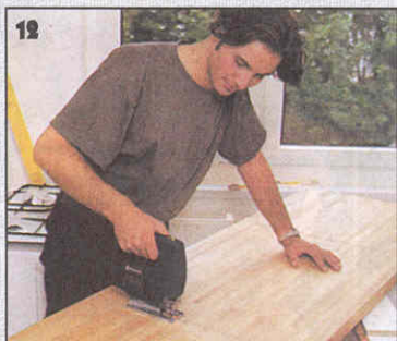
12 Отверстие для мойки вырезают электролобзиком. Чтобы кромки распила были чистыми, на электролобзик устанавливают приспособление, предотвращающее сколы.
